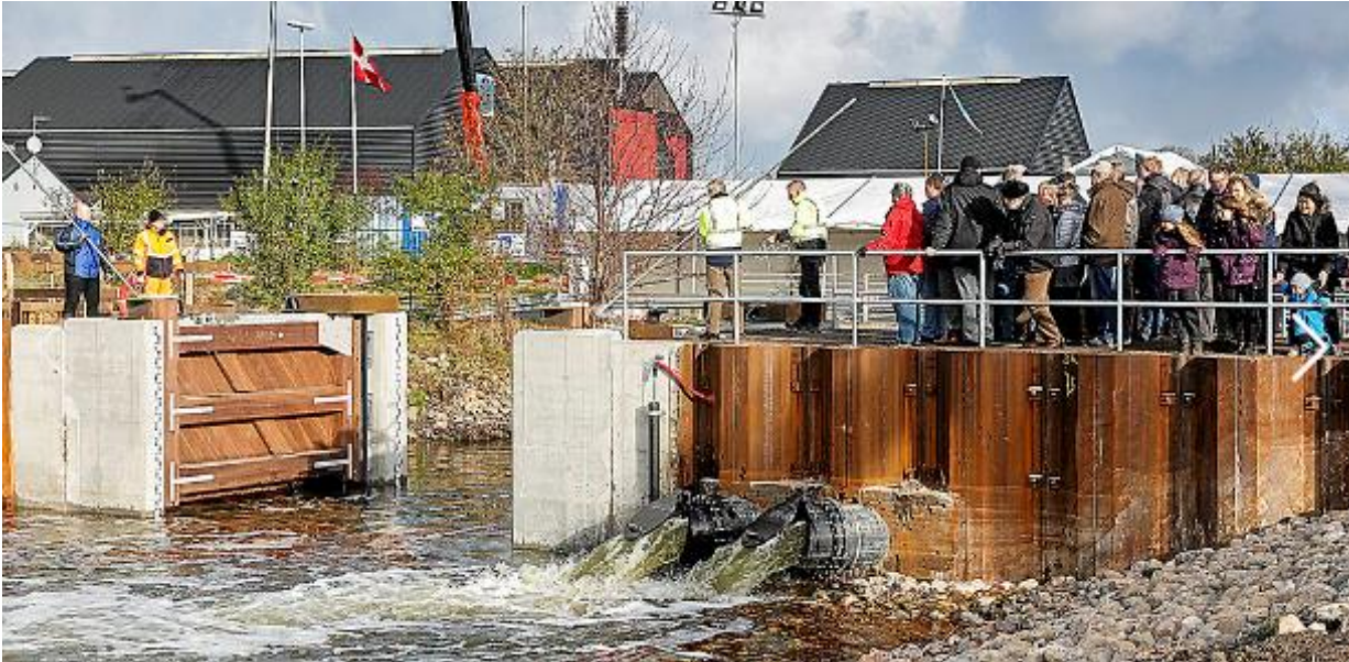
Figur 11.15: Pumpe og sluseanlæg, der sikrer mod at en stormflodshændelse forplanter sig til områder, der ikke er sikret mod den givne hændelse.
